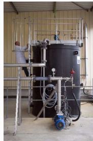
Neutralisation de pH au CO 2
